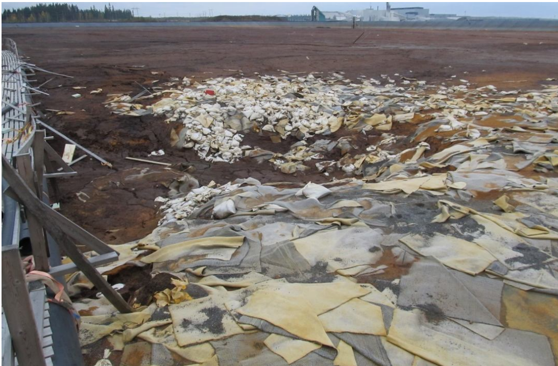
Kuva 3. Ykköskipsisakka-altaan vuotokohta ja vuodon tukkimiseen käytettyjä bentonittimattoja ja kivituhkasäkkejä.
